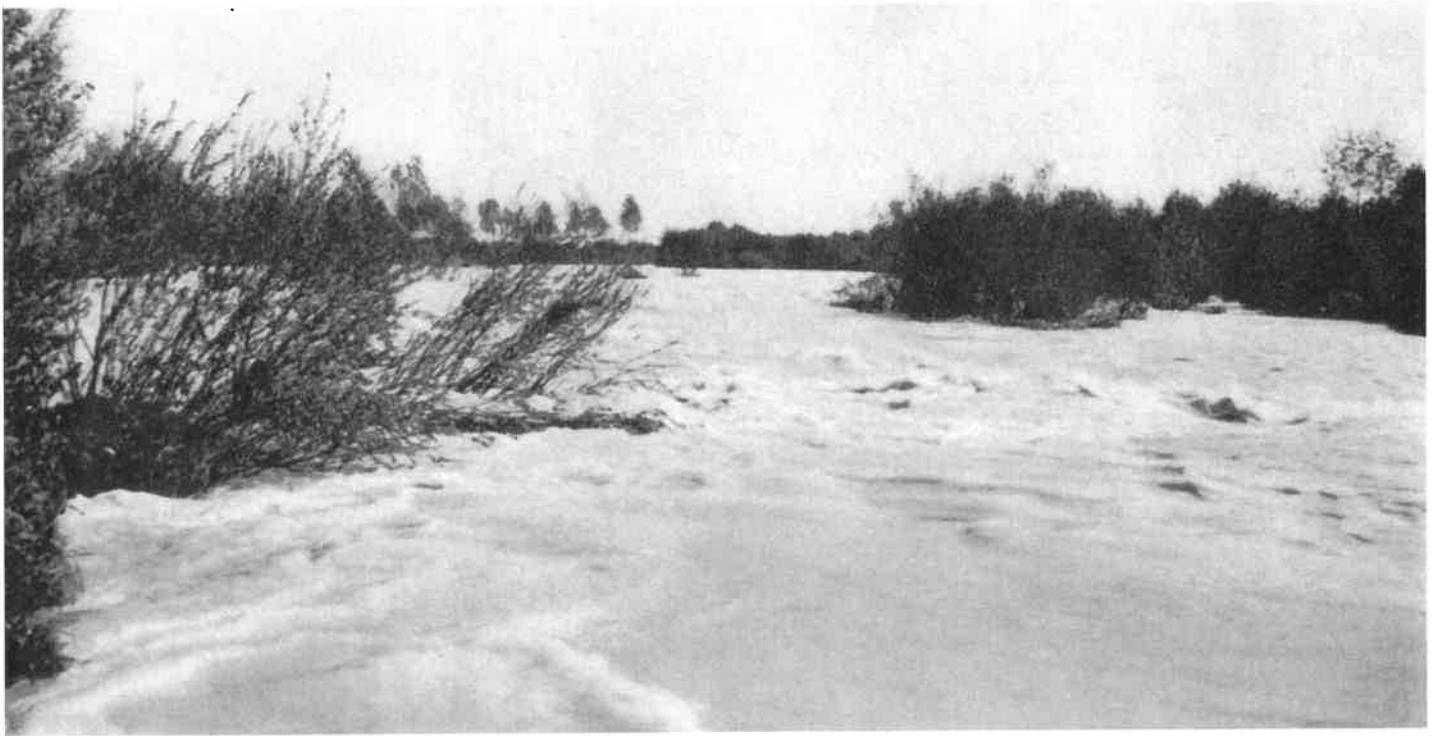
29. Am rechten Ufer bei km 48.0 (1 km oberhalb vom Hochablaß), Blick abwärts, nach Norden. Der Lech (links) hat den Betondamm zerbrochen und strömt
